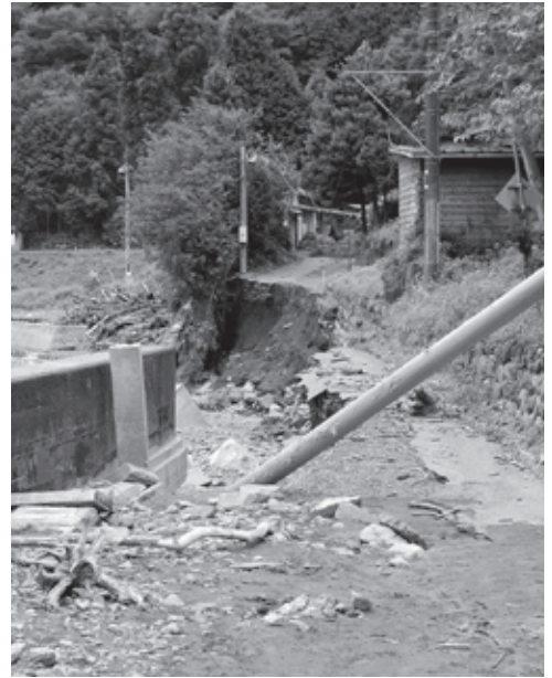
水の流れの勢いで削られた道路（世附地区）
