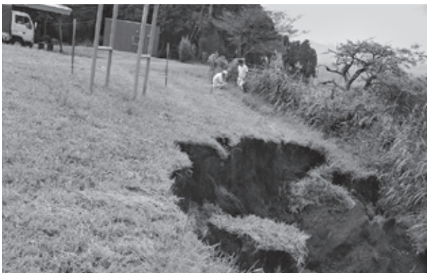
大野山山頂でおきた土砂崩落
